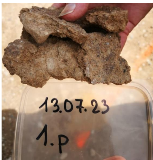
6-12. attēls. Ar lignosulfonātu atputeķlotā ceļa 1. posma grants seguma virsmas “garoza”.
