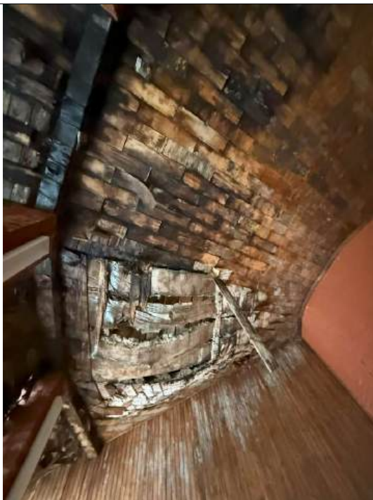
4.8.3 att. Daļēji sabrukusi jumta konstrukcija
