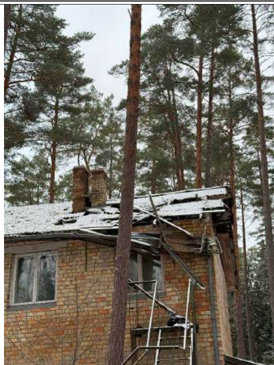
4.14.1 att. Ventilācijas kanāls, kas jāatjauno virs jumta līmeņa
