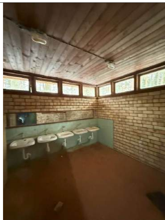
4.16.1 att. Aukstā ūdens un kanalizācijas cauruļvadi
