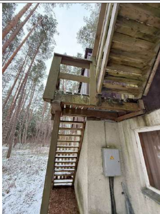
4.10.3 att. Koka ārējās kāpnes, kas ved uz trešo stāvu, kuras ir jāmaina
