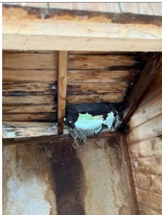
4.8.1 att. Sabrukušas jumta konstrukcijas
