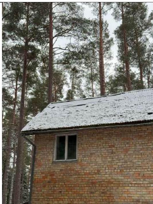
4.8.1 att. Jumta segums, kas ir norauts un visi nokrišņi nokļūst uz nesošajām konstrukcijām
