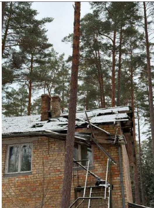
4.8.4 att. Jumta segums, klāja konstrukcijas, kas ir sabrukušas
