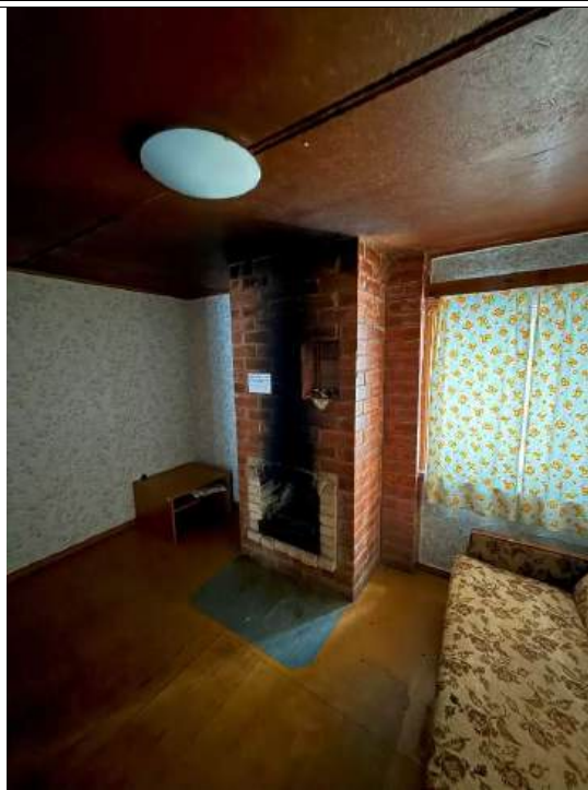
4.14.2 att. Kamīns, kas būtu jātīra
