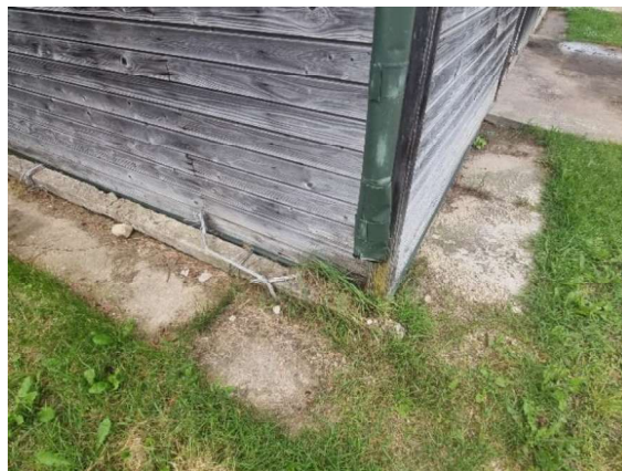
4.8.6. att. Bojāta lietusūdens noteka
