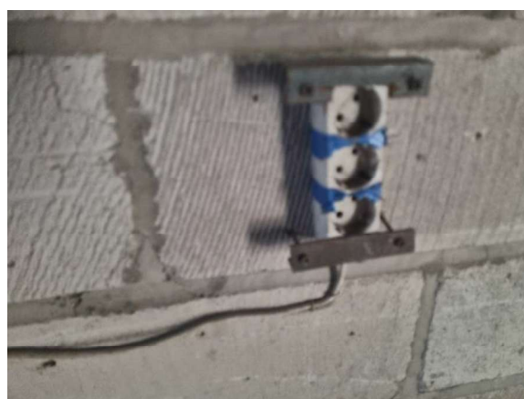
5.9.2. att. Elektroinstalācija neatbilst drošas ekspluatācijas nosacījumiem
