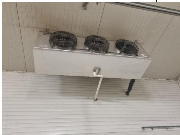
5.6.4. att. Kondicionieru iekšējie bloki
