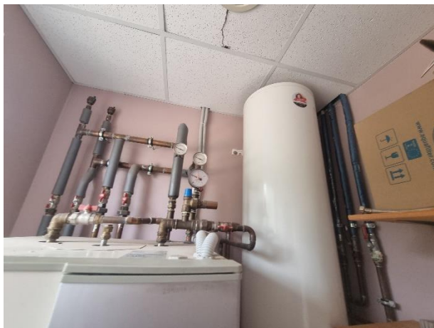
5.2.1. att. Karstā ūdens sagatavošanai uzstādīts ūdens sildītājs
