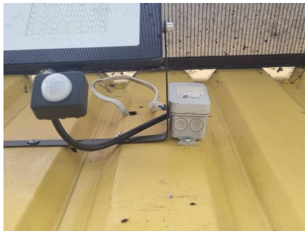
5.9.4. att. Kabeļi šķērsojuma vietā ar sienas apšuvuma skārdi nav ievietoti aizsargcaurulē
