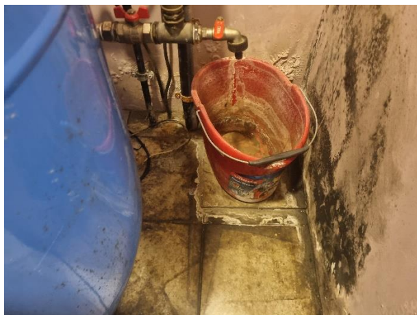
4.18.2. att. Uz sienām izveidojies pelējums
