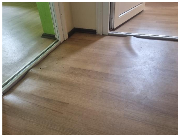
4.12.2. att. No pamatnes atlīmējies linoleja grīdas segums gaitenī
