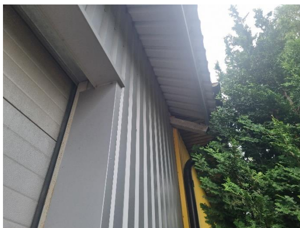
4.2.4. att. Skats uz ēkas ārsienām noliktavas daļā
