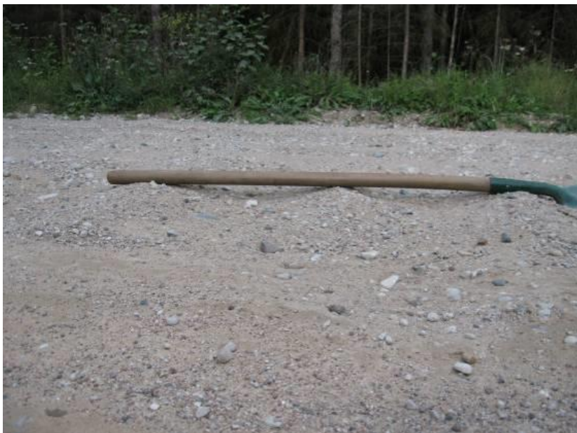
2.ATTĒLS Izžuvuša seguma deformācija – „trepe”
